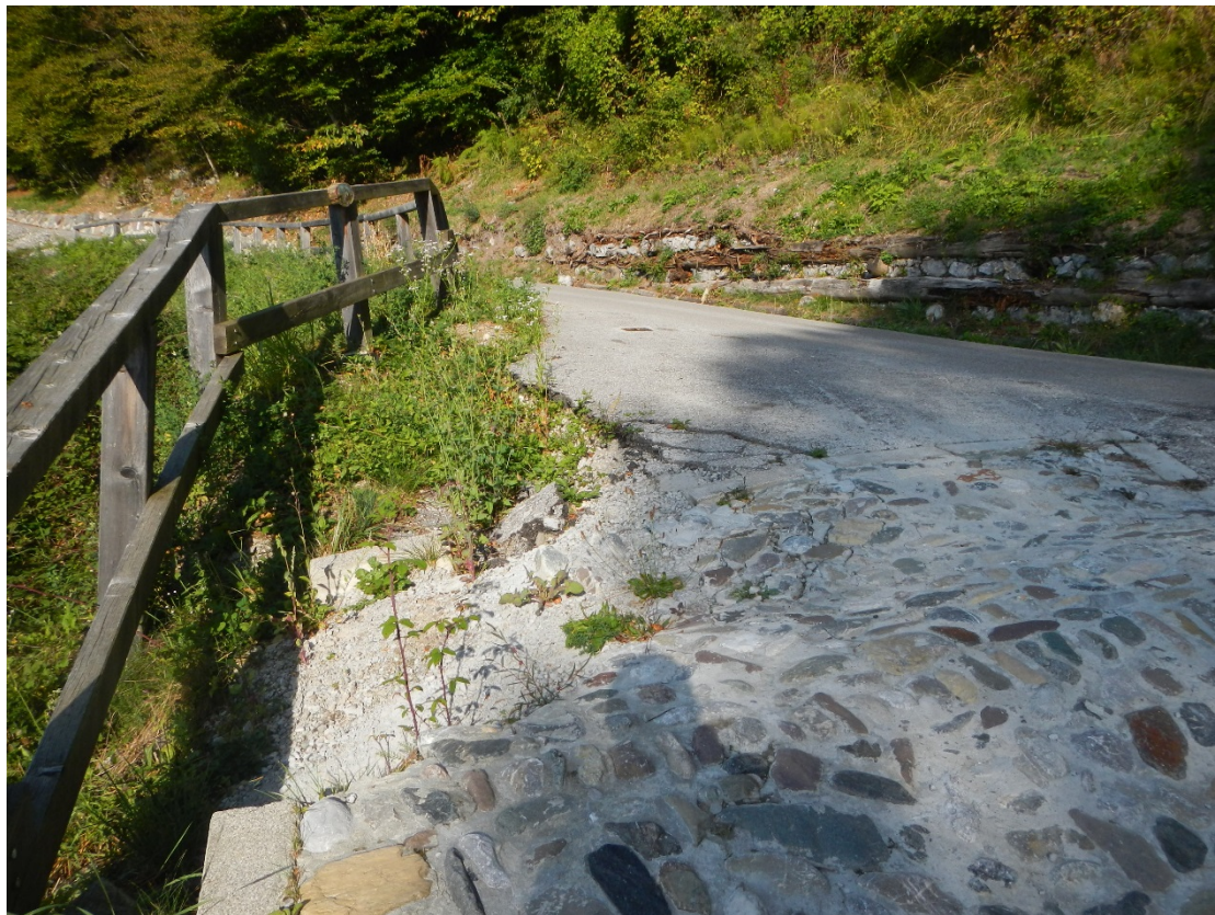
F5) Cedimento vistoso alla sezione 7 – vista dal basso verso l'alto.
