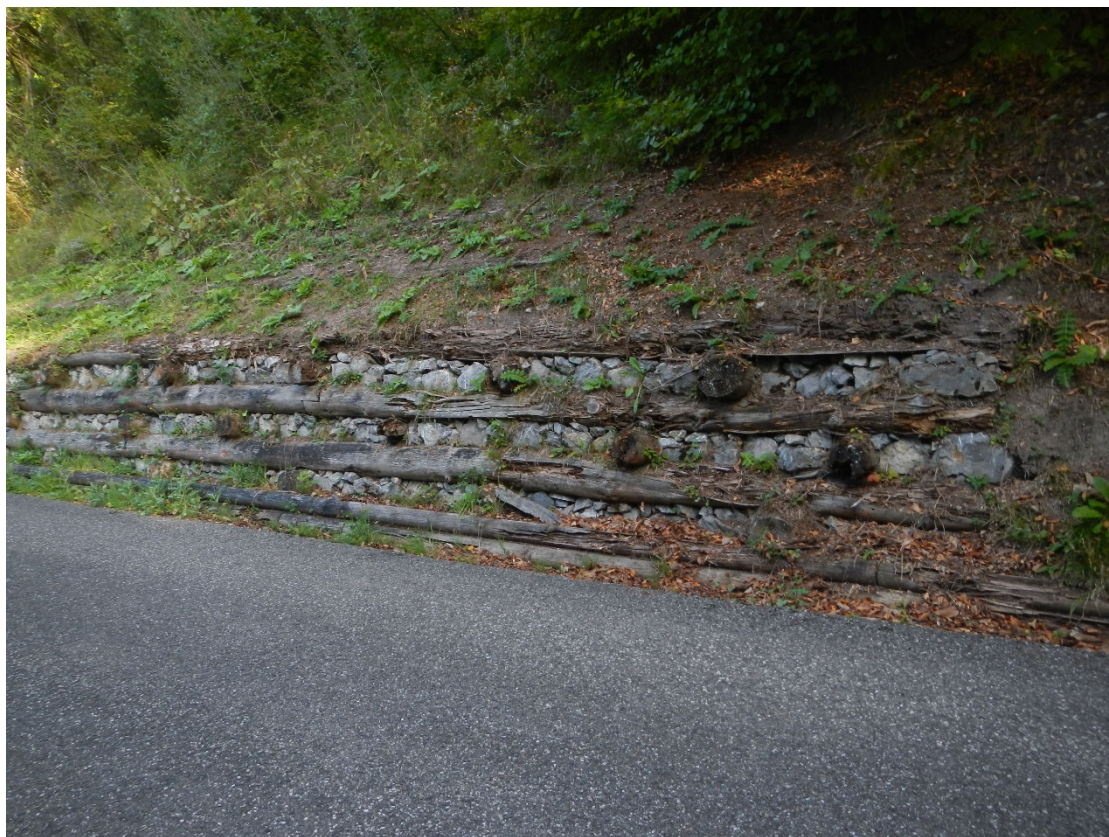
F3) Sezz. 4-5 – palificata doppia esistente, verso monte, molto degradata.
