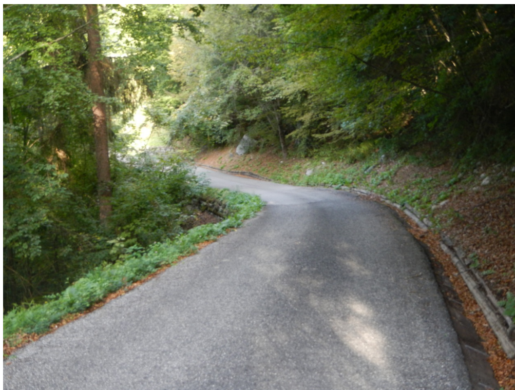
F1) particolare sezz. 0-2 viab. esistente con cunetta in legname esistente a monte e vistosi cedimenti.
