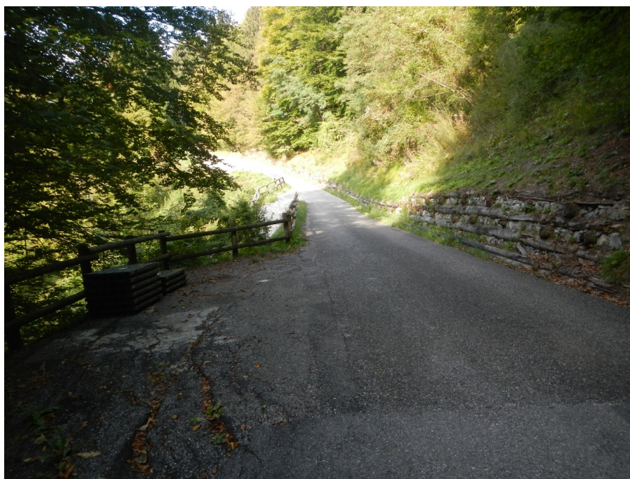
F2) palificata mista fatiscante verso monte e cedimenti evidenti verso valle.
